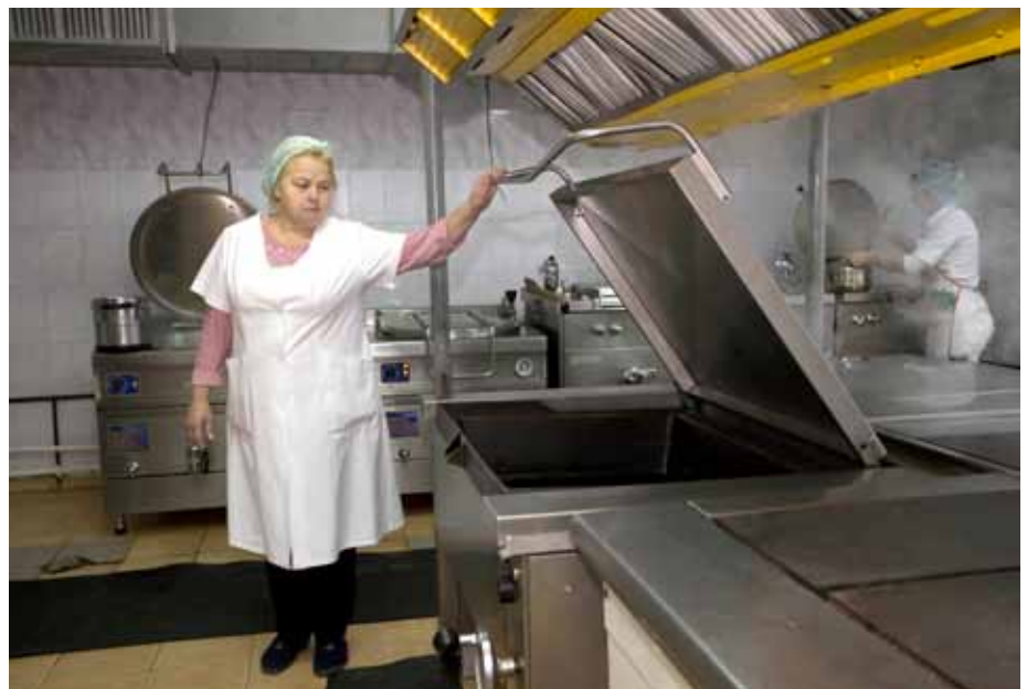
■ Die Chefköchin der Unfallklinik in Chisinau zeigt uns stolz die voll funktionsfähige eingebaute Kücheneinrichtung.
