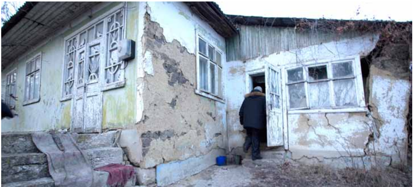
■ In ländlichen Gebieten finden wir immer öfter einsturzgefährdete Hütten, deren zahlreiche Bewohner die Kosten für Reparaturen nicht aufbringen können.
