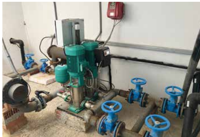
■ Pumpenanlage des Brunnens
