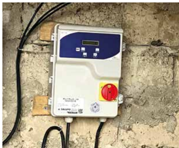
■ Die Schaltstelle für die Wasserversorgung in Bahu.
