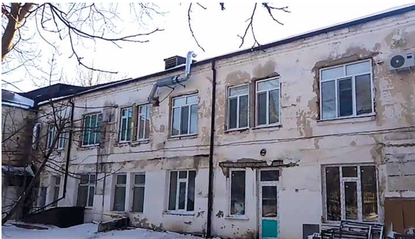
■ Teil der beschädigten Außenfassade auf der Rückseite des Hauptgebäudes IMSP Spitalul in Carpineni am 16.02.2026.
