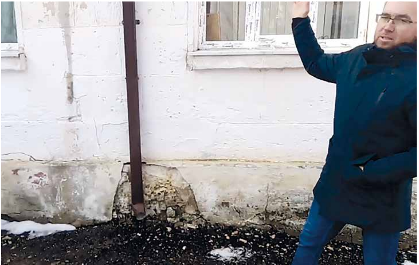
■ Im Gespräch mit Ion Purice (Geschäftsführer) zum Zustand der Außenfassade.
